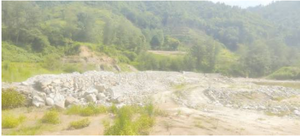
कोल्पु खोला नदी नियन्त्रण
